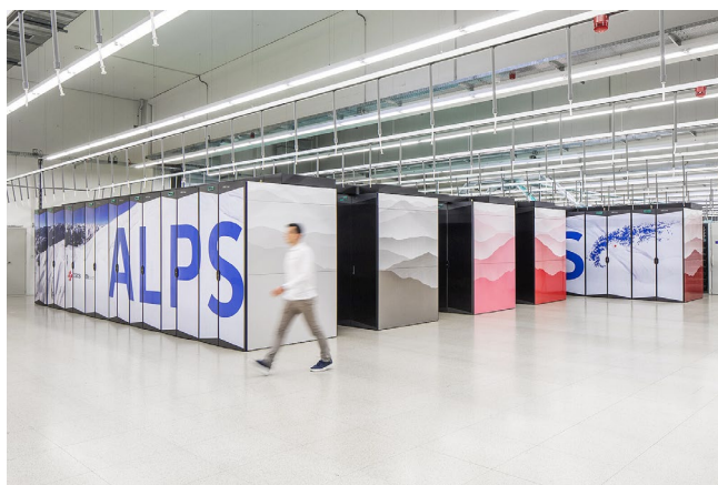
Figura 2 – Il supercalcolatore ALPS presso il CSCS a Lugano
